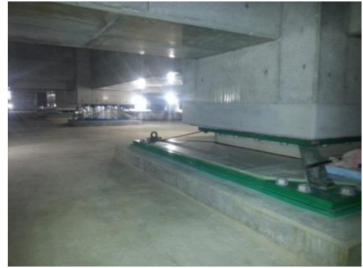
地下の免震装置
