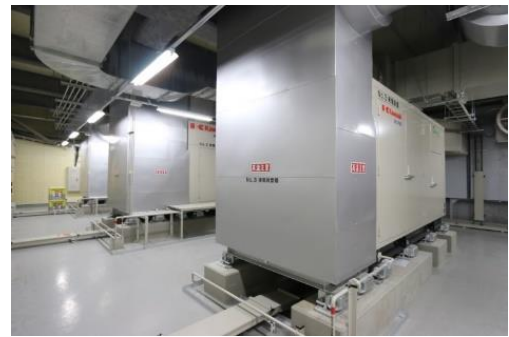
3台の非常用発電機
